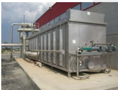
Impianto acque primarie: unità di flottazione Idraflot™
