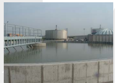
Vasca di decantazione
